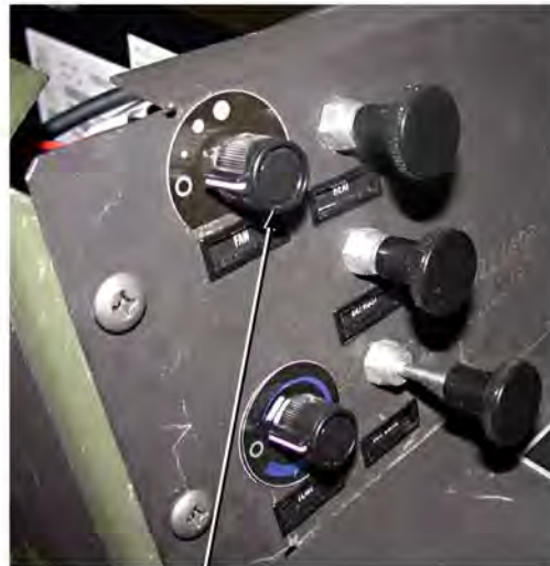
FAN CONTROL SWITCH
